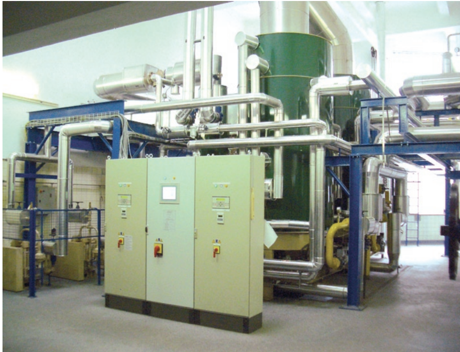
Innenansicht der neuen Energiezentrale bei Südleder mit den kompakten Schnelldampferzeugern in vertikaler Bauweise
