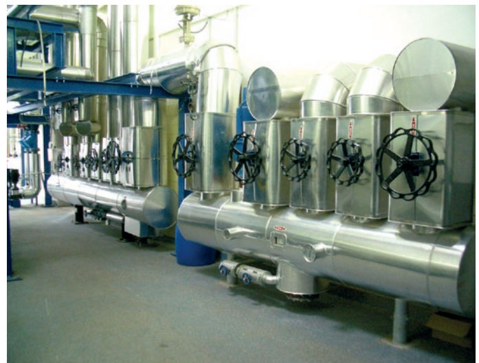
Dampfverteiler – links von Clayton Deutschland gelieferter Verteiler für 13 bar Arbeitsdruck, von dem aus der Dampf auf den Niederdruckverteiler überströmt
