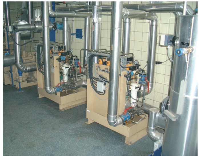
Für jeden Kessel ist eine Fett-Dieselöl-Verteilerstation vorhanden; sollte kein Fett mehr vorhanden sein, wird auf Dieselöl automatisch umgeschaltet
